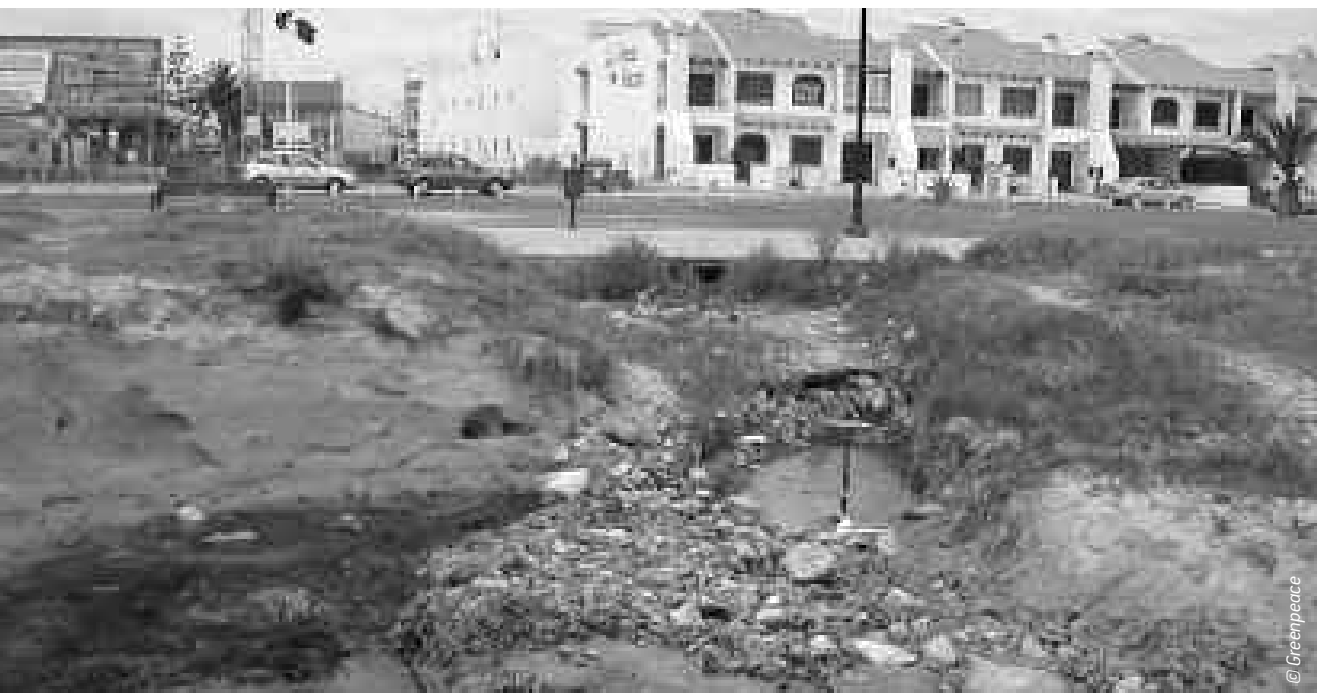
Desagüe de lluvia en el paseo marítimo. Cala del Mojón, Torrevieja (Alicante).
