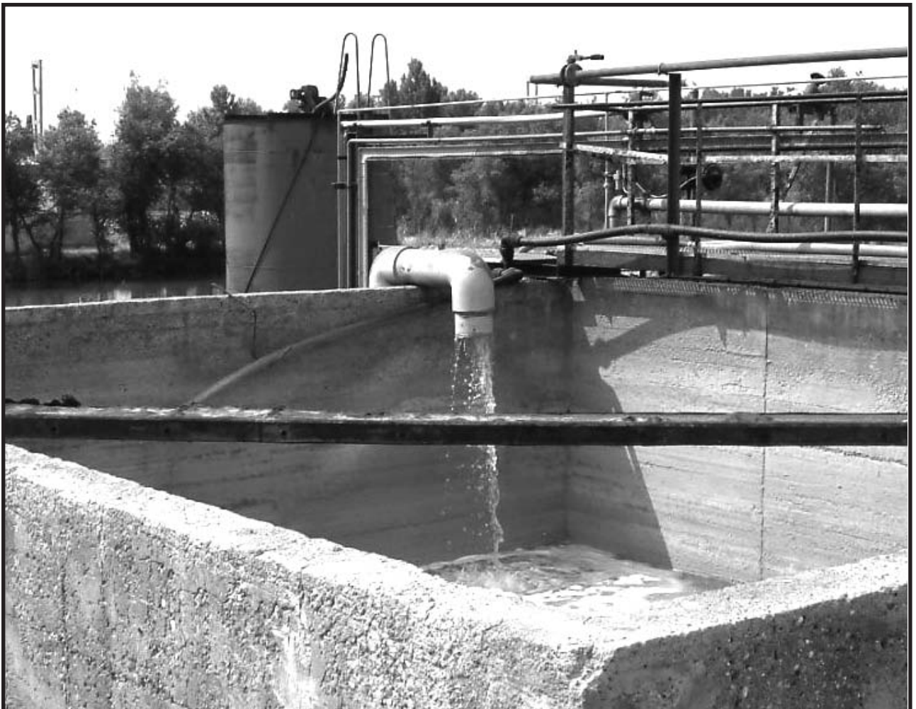
Imagen de la depuradora de la planta de Montecinca en Monzón
