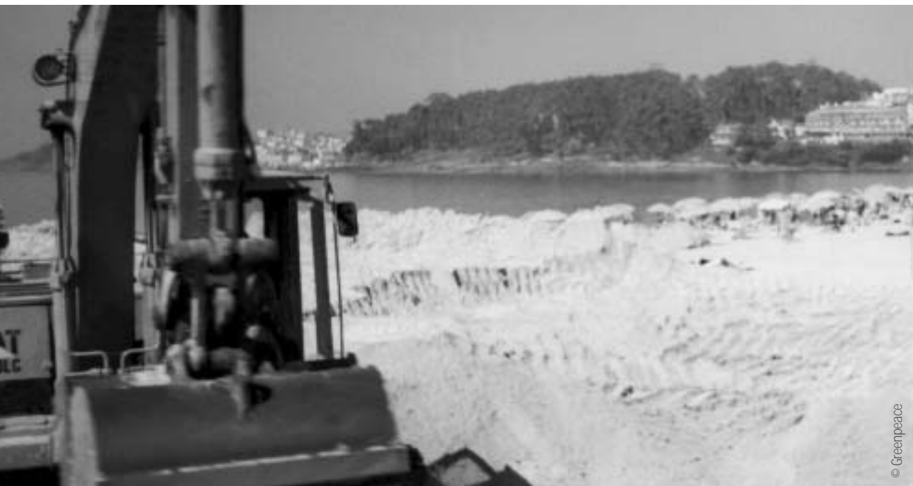
Máquinas trabajando en la regeneración artificial de la playa de Silgar, Sanxenxo (Galicia).
